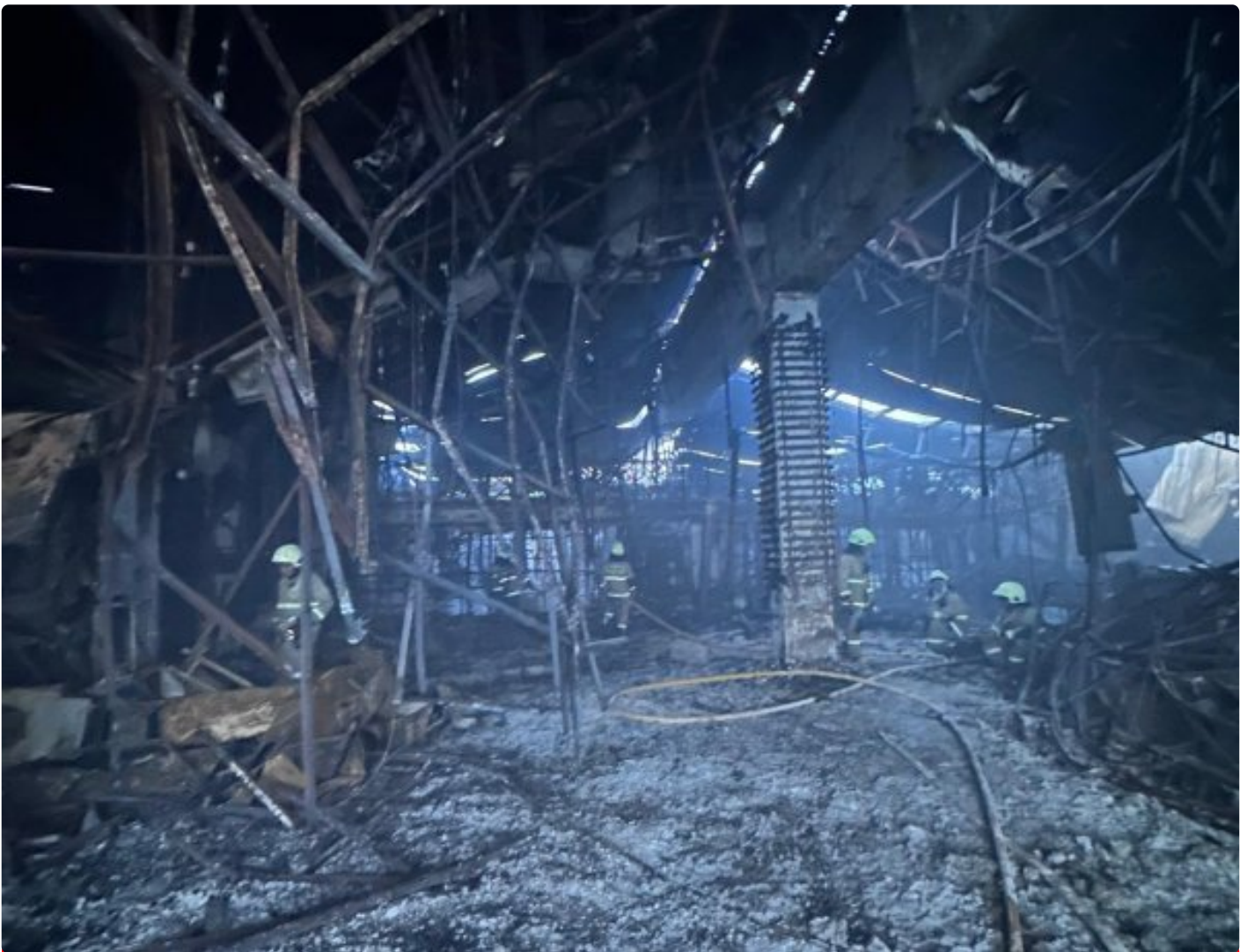
Glodok Plaza yang Hangus Terbakar
